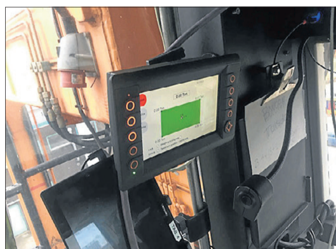
Et eksempel på de displays, der er interface mellem kranføreren og Lasstec-systemet. Foto: Power Flex
