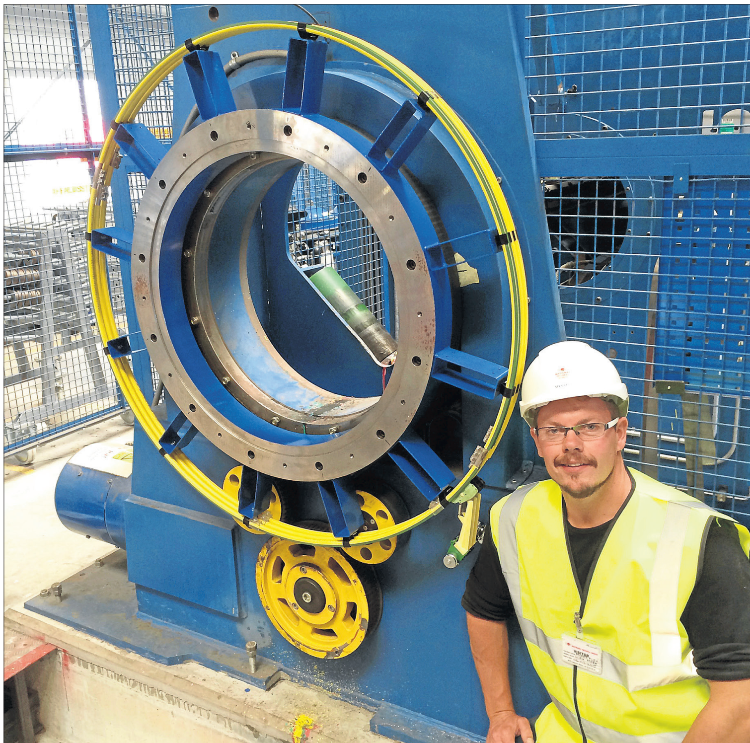
Ulrik Mark ved en af de store kabeltromler, Power Flex servicere på danske havnekraner. Fotos: Power Flex
